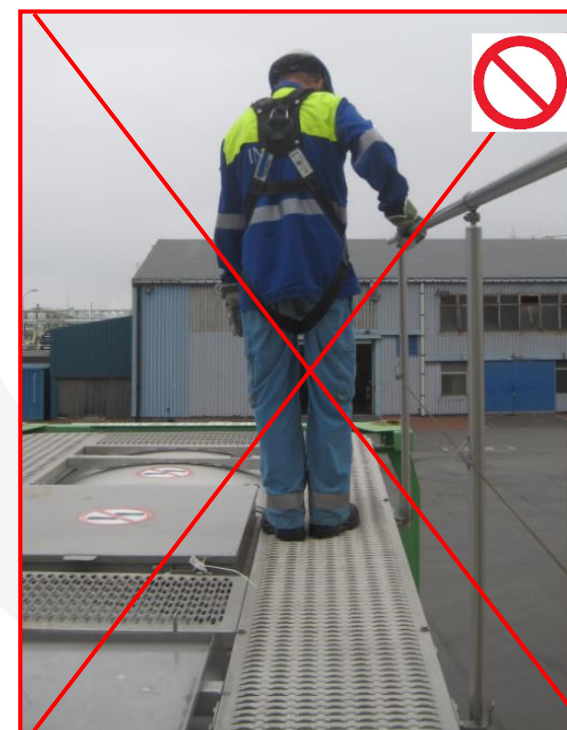
Poręcz bez zabezpieczenia przed upadkiem
