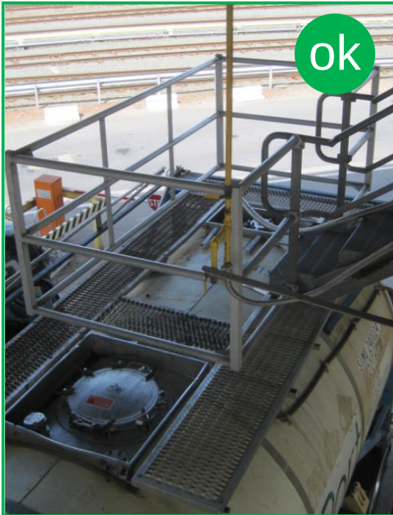
Grilaj de protecție
